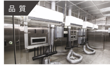
領先業界33間空調試驗室
